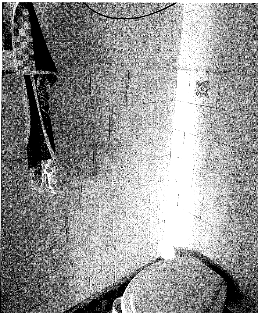
A WC- fürdőben is látható az alapsüllyedésből adódó repedés.
